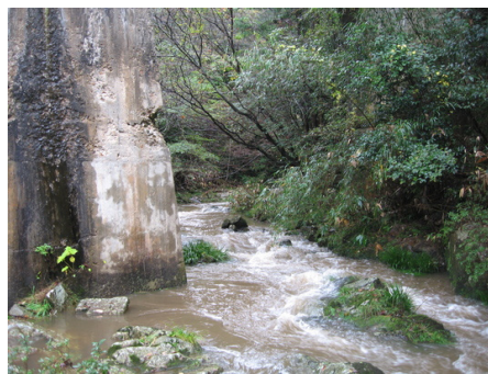
2 橋目 4 連アーチ橋 (橋脚破損)
