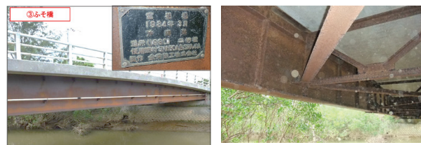
写真-5 『通行止め』の富祖橋
