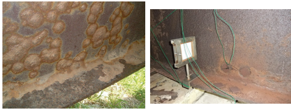
写真-8 異常腐食した鋼板表面（島根県）
