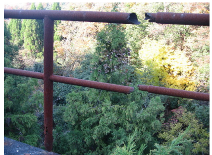
防護柵破損（第一下府川橋梁）
