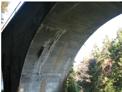
アーチ橋（エフロレッセンス）
