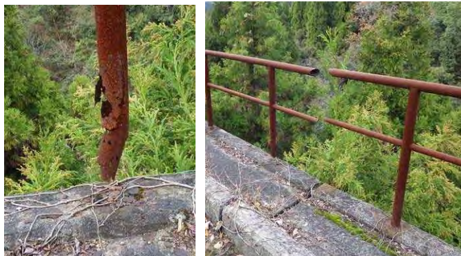
写真 15：朽ちた防護柵
