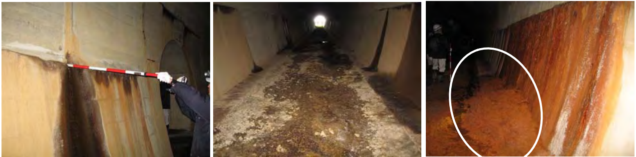
a)側壁部の空洞と漏水
