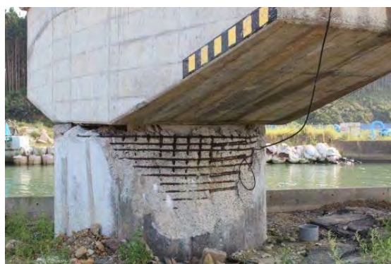
P.12 国道 45 号の橋脚 コンクリートで巻立て補強した部分が剥離する
