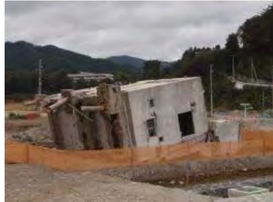
P.18 鋼管杭が切断されて横たわる建物
