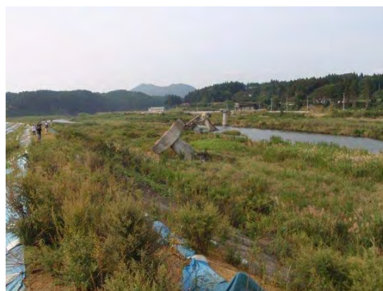
P.11 上流側(写真左側)に傾倒する 気仙沼線の橋脚
