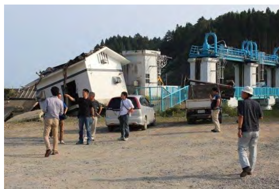
P.13 樋門および付帯施設の変状
