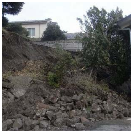
写真-2 擁壁の崩壊（三瓶町）
