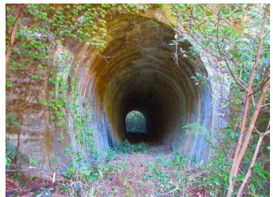
発見した有福第4トンネル
