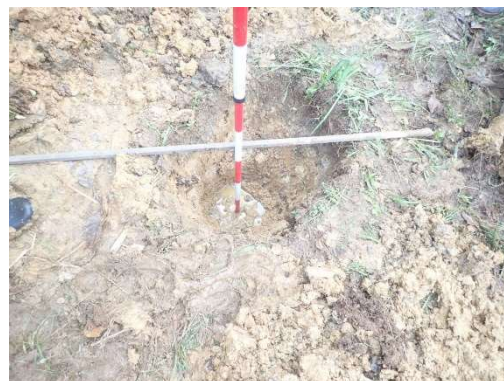
写真-8 試掘したトンネル上面のコンクリート を発見。土かぶり 70 cm。
