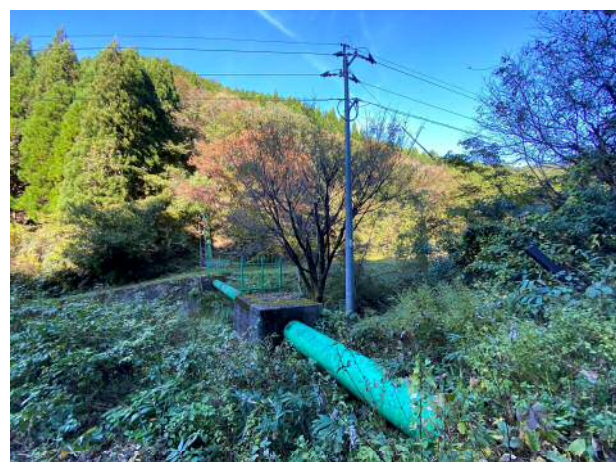
川東水路のサイホン設備
