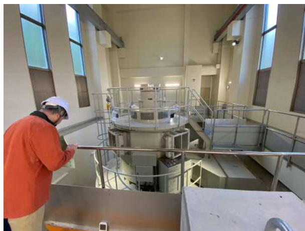
三成発電所内
