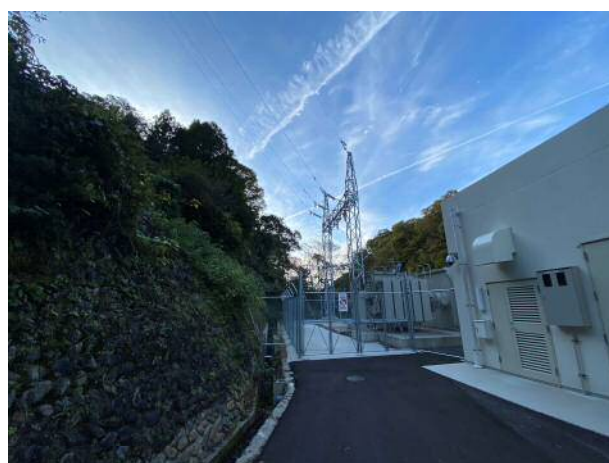
ガス絶縁開閉装置
