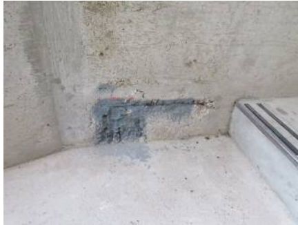
駅階段部の鉄筋露出
