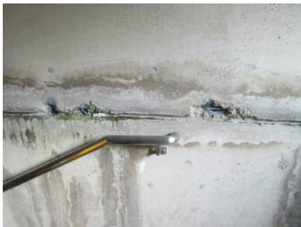
駅階段の鉄筋露出
