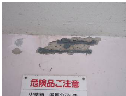
階段最上部の鉄筋露出
