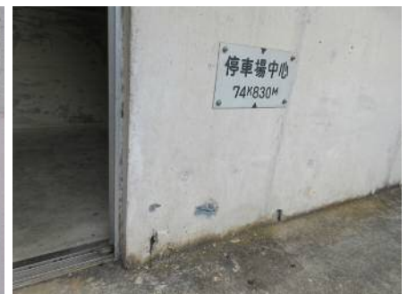
ホーム出入口部の鉄筋露出
