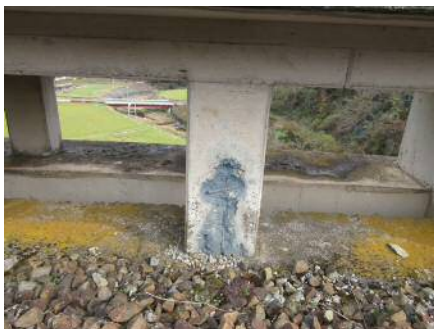
駅ホーム柱の鉄筋露出
