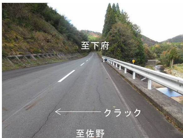
図 3.2.3 舗装クラック
