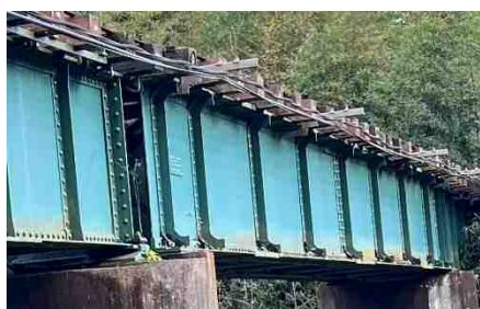
写真 5 川平橋りょう 3連目鉄桁 Jの字形のスティフナー
