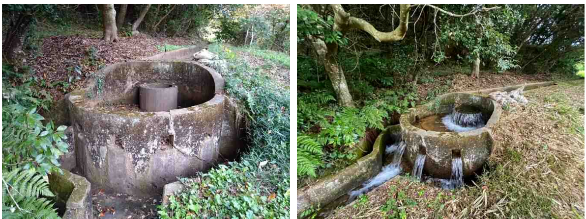
写真-1 偏心式円筒分土工(右が8月31日に用水が流れている様子)
