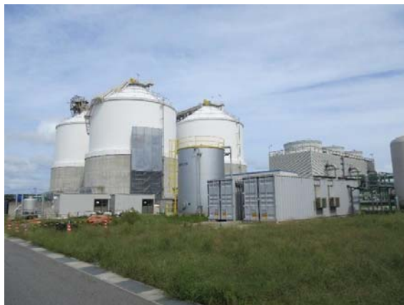
写真 3-2 燃料貯留槽（サイロ）B1.B2
