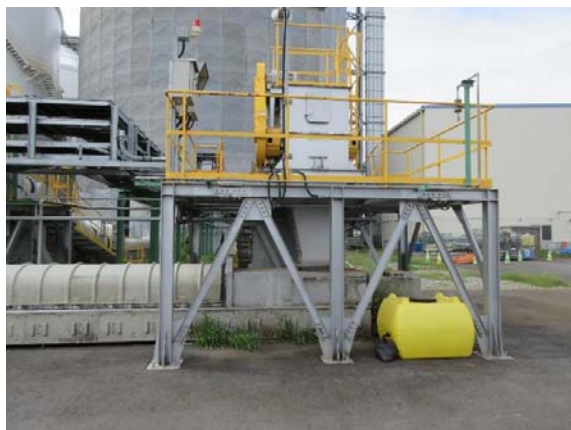
写真 3-7 A 1サイロからのコンベア の接続部
