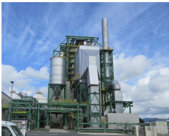
写真 3-10 燃料灰貯槽、排ガス集塵装置、排気筒
