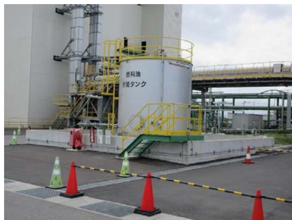
写真 3-9 ボイラーの着火用の灯油タンク
